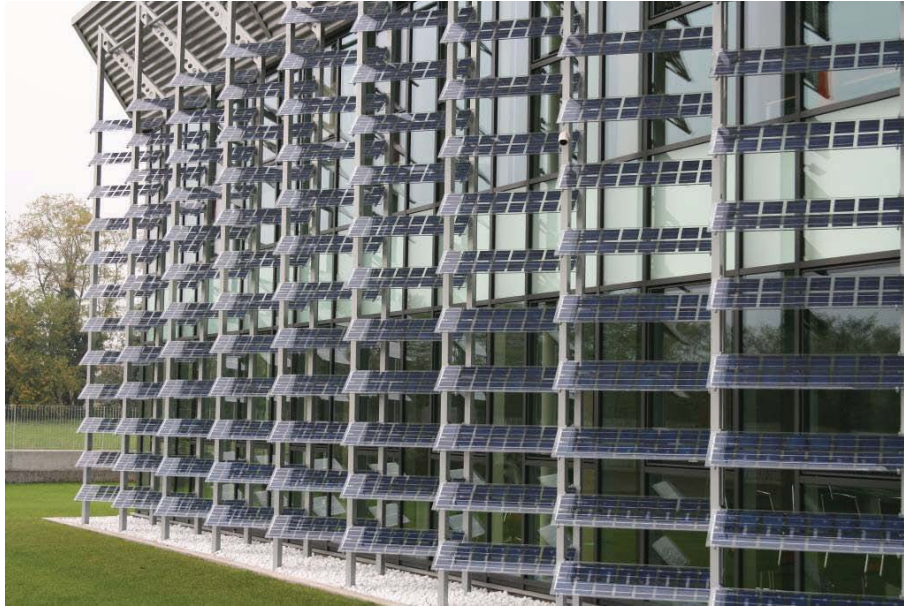
Fig.22 – Esempio di installazione idonea alla classificazione dell’impianto fotovoltaico nella categoria “su edifici”
