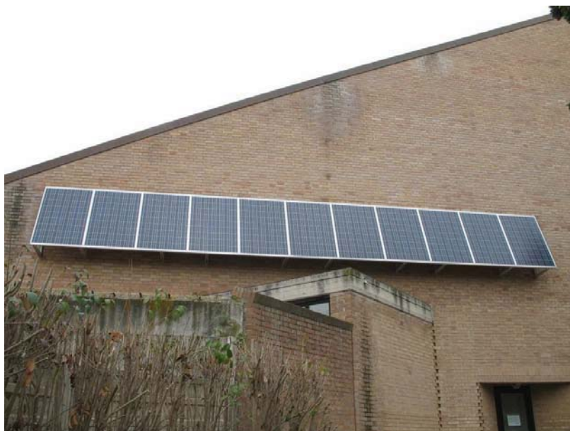
Figura 24 - Esempio di installazione non idonea alla classificazione dell'impianto fotovoltaico nella categoria "su edifici" – Motivazione: la struttura collegata non sottende superfici trasparenti
