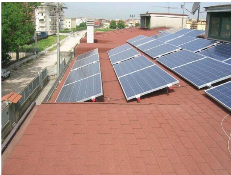
Figura 9 - Esempio di installazione non idonea alla classificazione dell'impianto fotovoltaico nella categoria "su edifici" – Motivazione: i moduli non sono complanari alla falda di copertura
